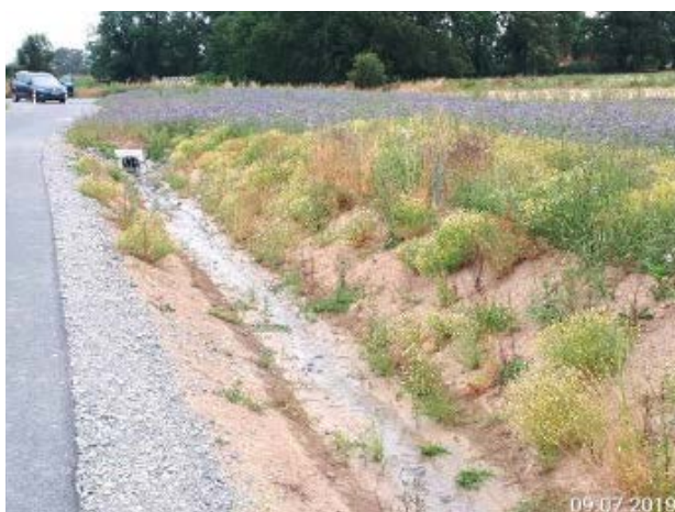
Zur Vorklämung und Rückhaltung des klärflichtigen Niederschlagswassers wurden Mulden-Rigolen-Systeme erstellt.
